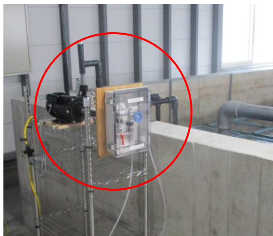
ATコンポ 陸上ポンプタイプ設置状況
