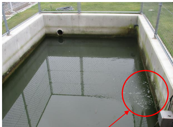
ATコンポ 水中ポンプタイプ設置場所
