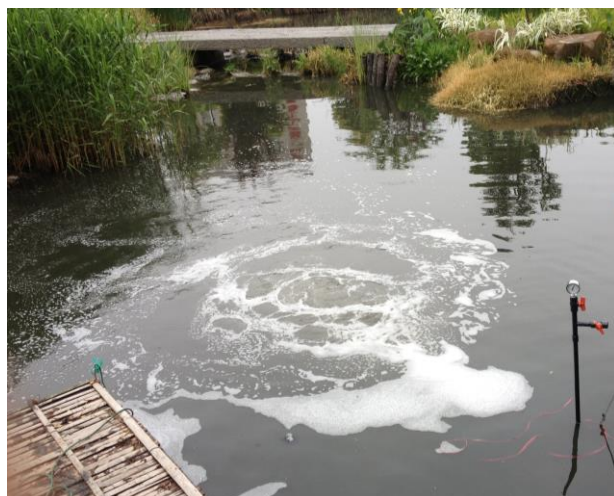
ATコンポ 水中ポンプタイプ稼働状況
