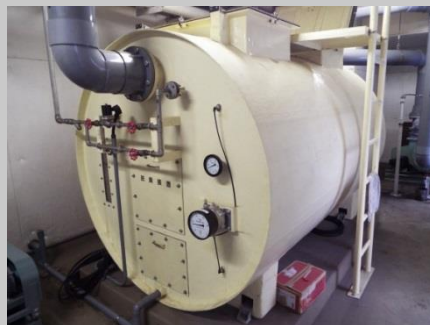
生物脱臭装置
